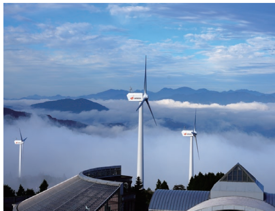
高知県大豊町のアウトドア観光施設「ゆとりすとパークおおとよ」に設置されている四国電力(株)の風力発電設備
