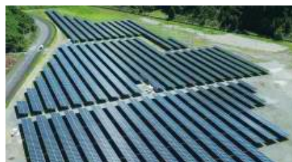
徳島県那賀町の太陽光発電設備
