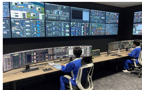
統合エネルギー管理の様子
